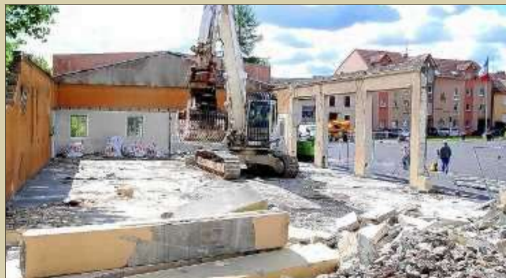
Les bâtiments datent de 1964 et la caserne (ici l'ancien garage) sera réhabilitée d'ici à l'été. Un moment très attendu par les sapeurs-pompiers. Photo RL
